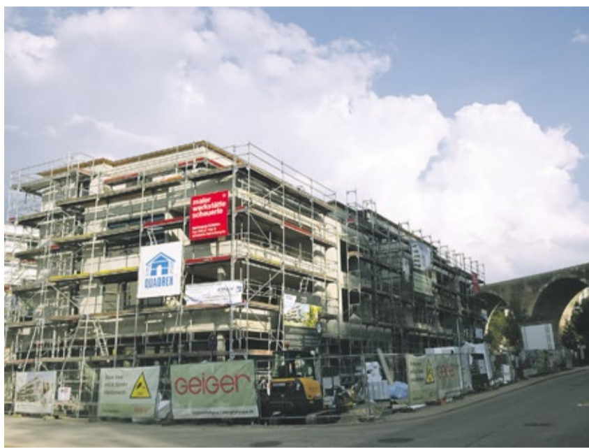
Die meVita Nagold „Residenz am Riedbrunnen“: schön und zentral gelegen auf dem Gelände der ehemaligen Landesgartenschau.
